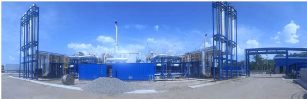
Imagen 1: Planta de generación POLYGROUP Energía (POLYGESA)
