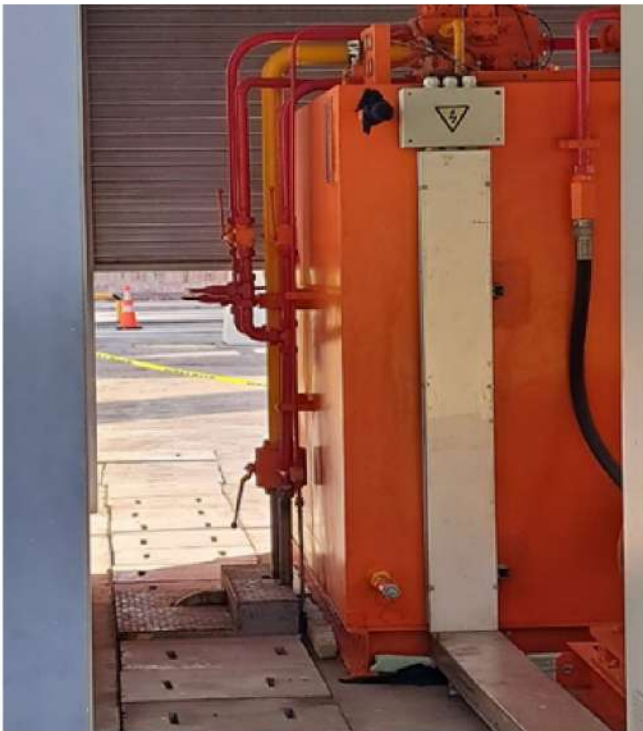
TANQUE DE ACEITE DE LA COMPUERTA N.3
