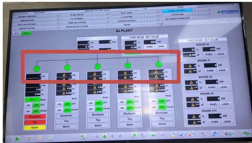
Imagen 10: Pantalla del sistema SCADA de unidades inactivas, grupo de unidades declarado en la ficha de Registro Público
