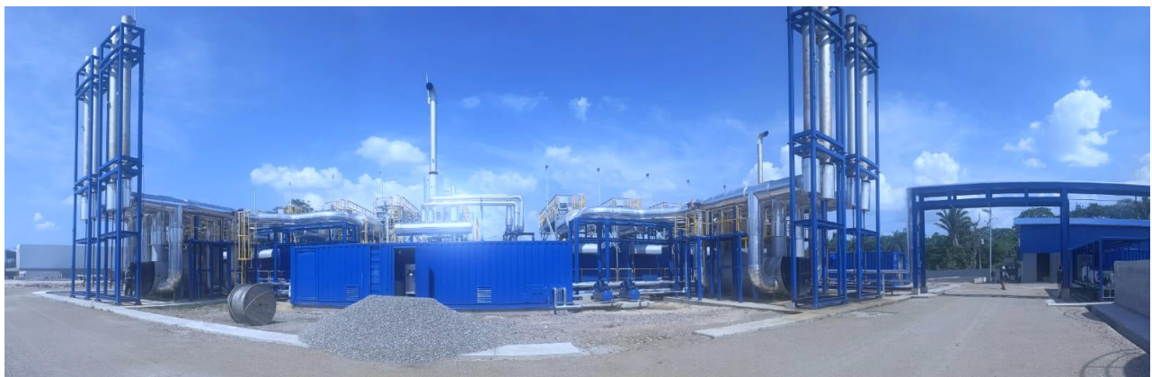
Imagen 5: Planta de generación POLYGROUP Energía (POLYGESA)
