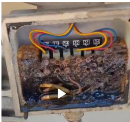
Figura 13 Fotografía de la bornera del transformador T546 (fuente personal operativo ENERSA)
