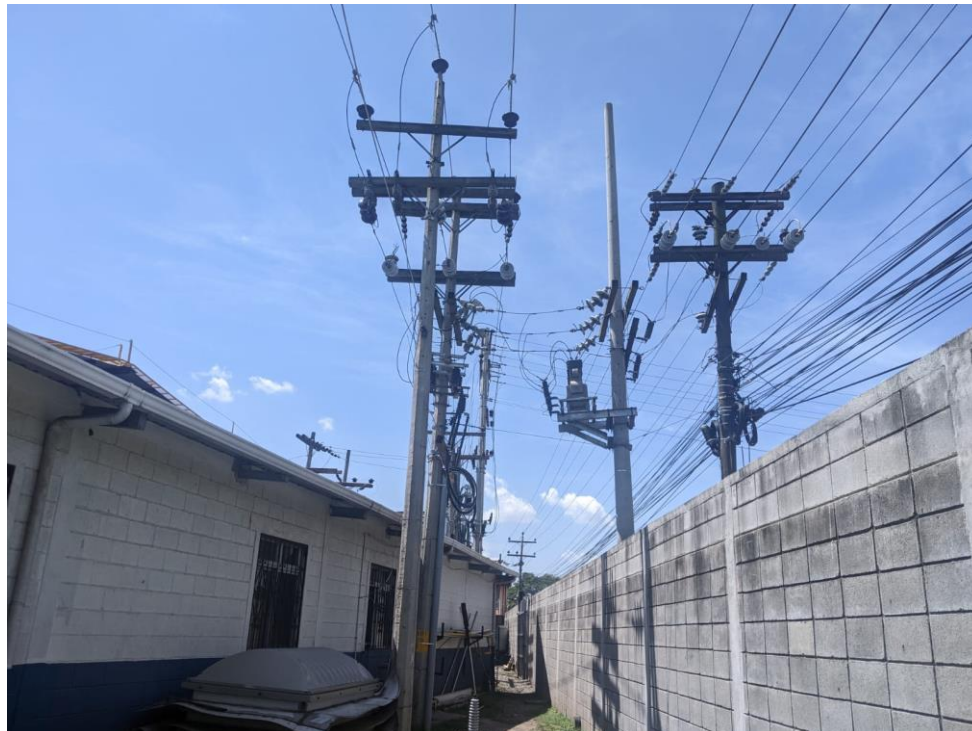
Imagen 12: Estructura doble terna
