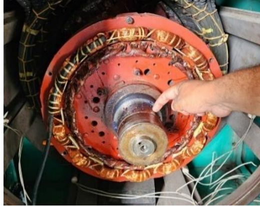
Figura 6 Daño en el rodamiento del generador U19 POS3
