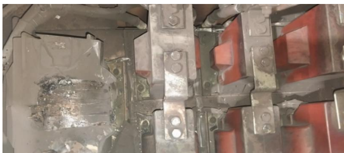
Figura 11 Fotografía de TP que suministra potencial al AVR en falla de la unidad U2 (fuente reporte de falla GEN U2 17 de junio, Mantenimiento Eléctrico La Ensenada)
