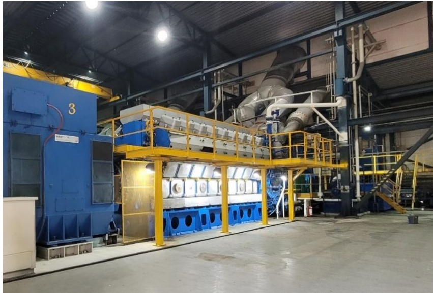
Figura 5 Motor y generador de la unidad número 3, central térmica LUFUSSA II.
