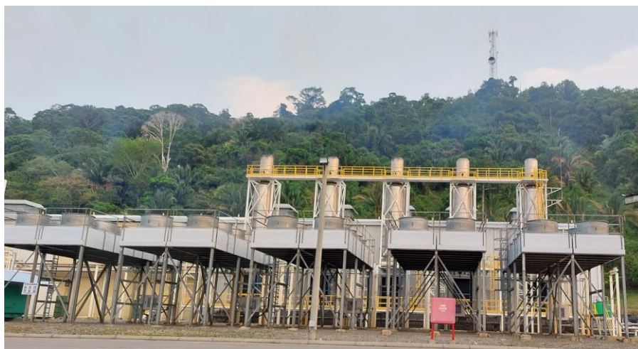
Figura 7 Instalaciones de la central térmica La Ensenada.
