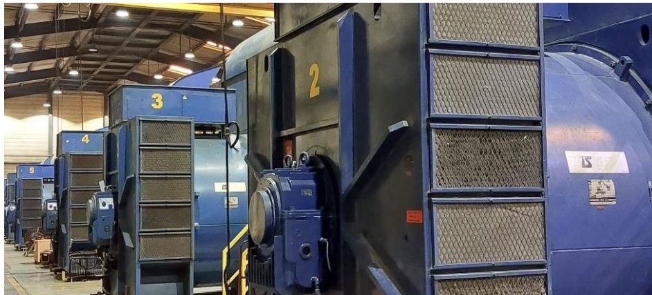
Figura 8 Instalaciones de la central térmica ELCOSA.
