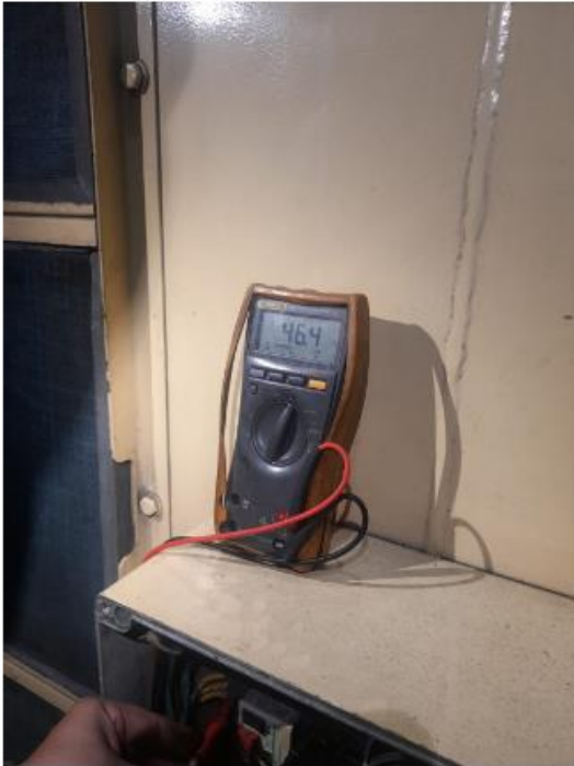
Unidad 2. Breaker con alta resistencia, valor 46.4 ohms.
