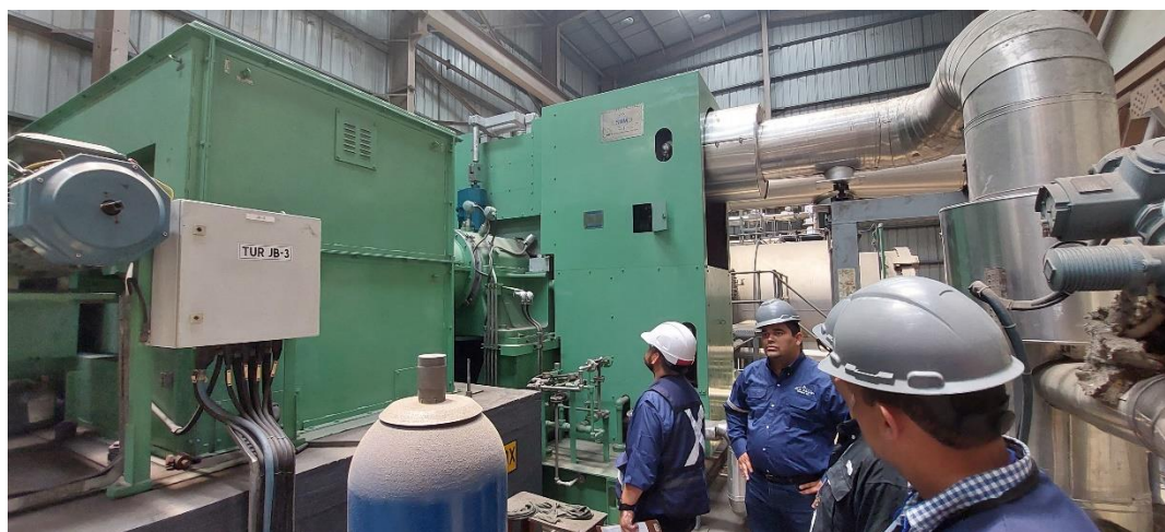
Figura 13 Instalaciones de la central generadora de biomasa Green Power Plant.
