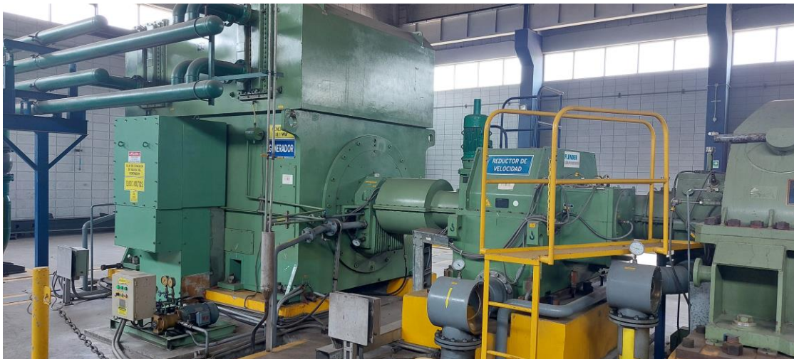
Figura 12 Instalaciones de la central generadora de biomasa Merendon Power Plant.
