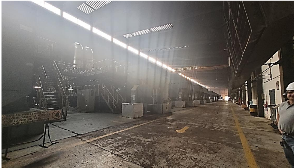
Figura 10 Instalaciones de la central térmica ENERSA.
