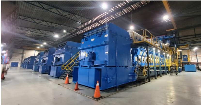
Figura 6 Instalaciones de la central térmica LUFUSSA III.
