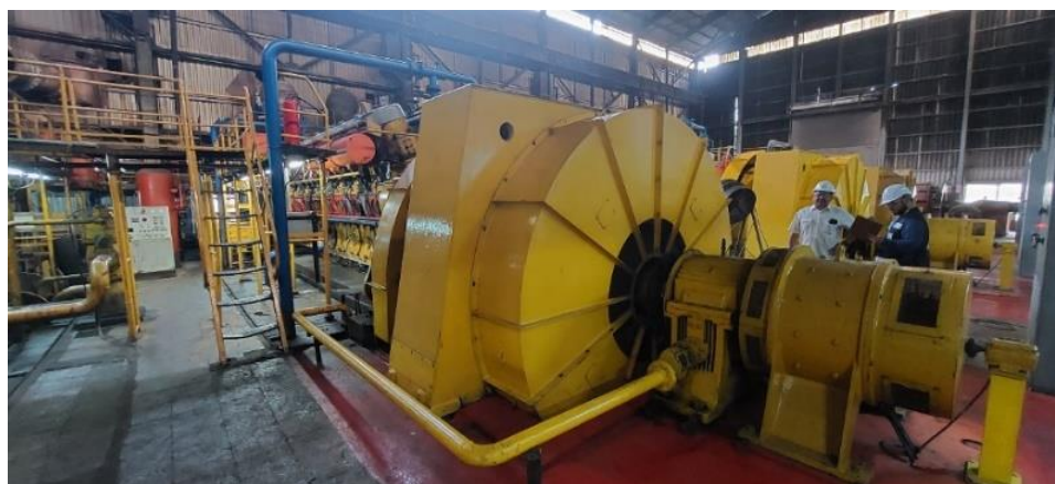
Figura 2 Instalaciones de la central generadora Ceiba Térmica.
