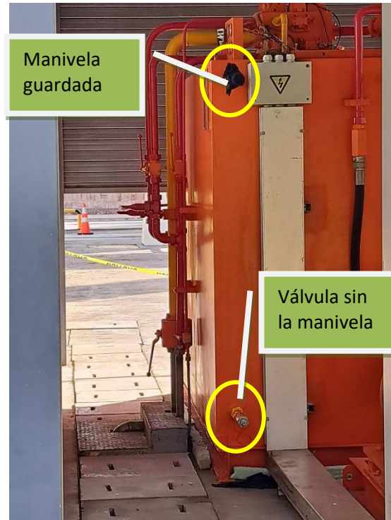
Ilustración 2 Tanque de aceite de la compuerta N.3
