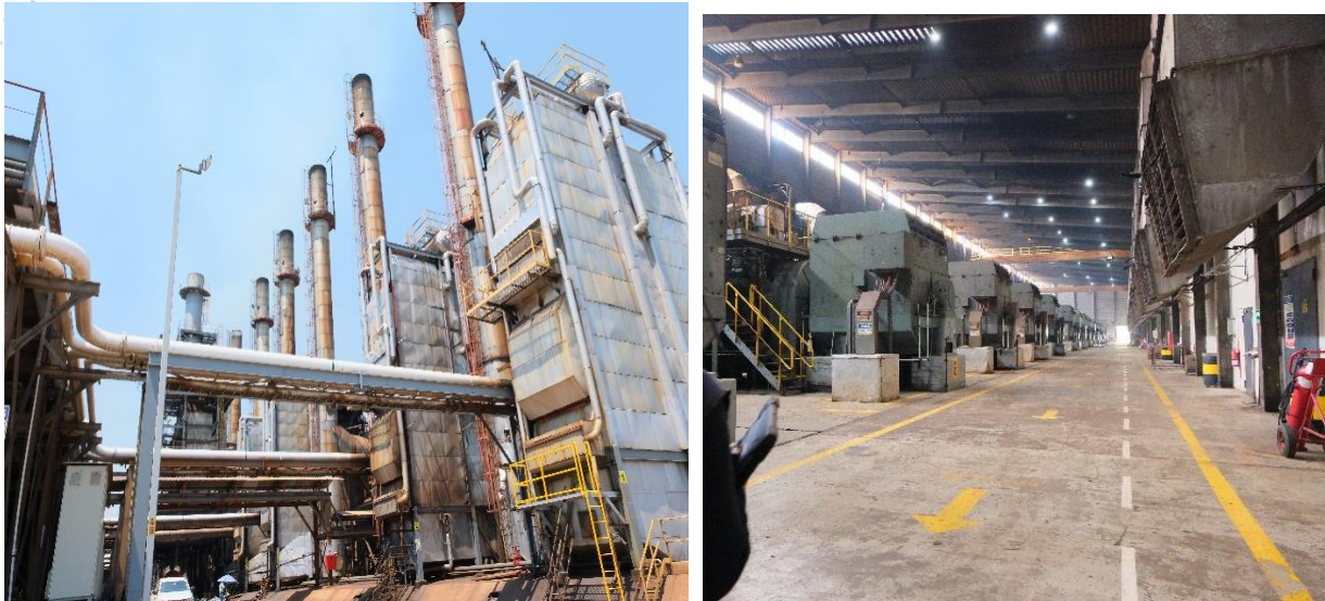
Figura 7 Unidades de generación de la central ENERSA (fuente propia)
