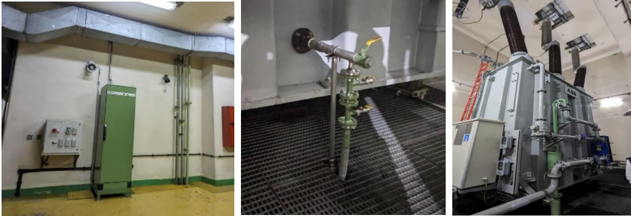
Figura 35 Equipo del sistema contra incendio instalado (fuente propia)
