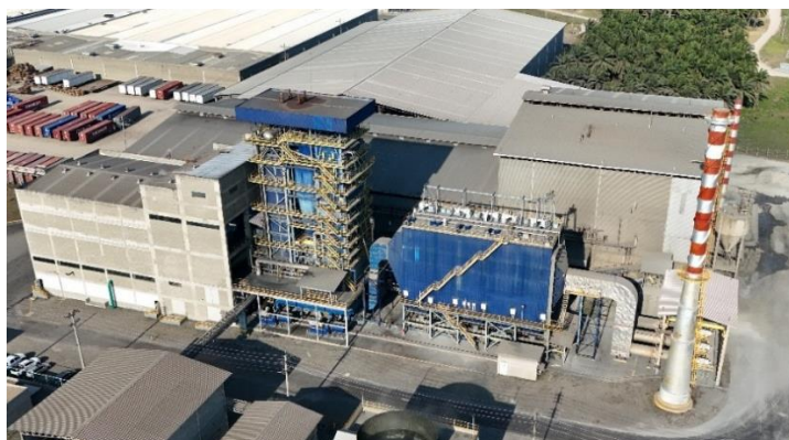
Figura 19 Unidad CKP-U1 -18.1 MW (fuente propia)
