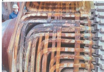
Imagen del daño en el rotor del generador.
