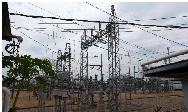
Figura 48 Subestación Juticalpa 34.5kV
