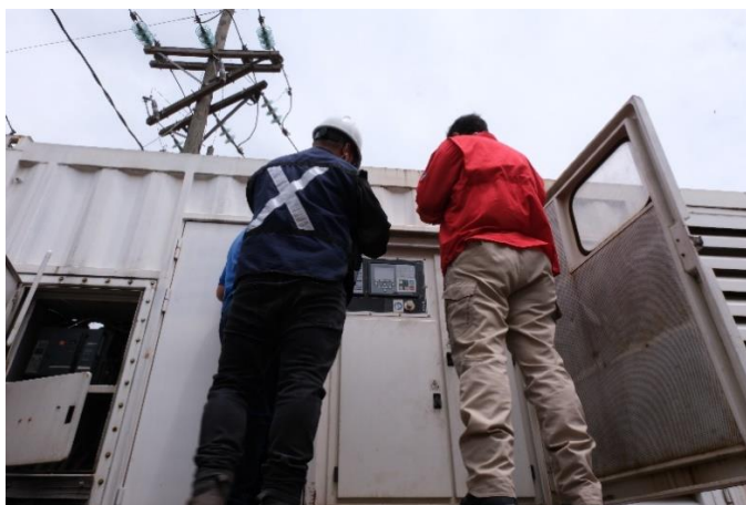
figura 51: Paro de una unidad generadora presentada al momento de la inspección por bajo voltaje de la red de distribución.
