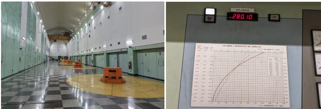
Figura 32 Unidades de generación y control de nivel de embalse de la central El Cajón (fuente propia)
