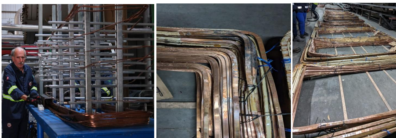
Figura 17 Izquierda: Limpieza y enderezado de espiras. Centro: Espiras dañadas. Derecha: agrupaciones de espiras dañadas. (fuente propia)
