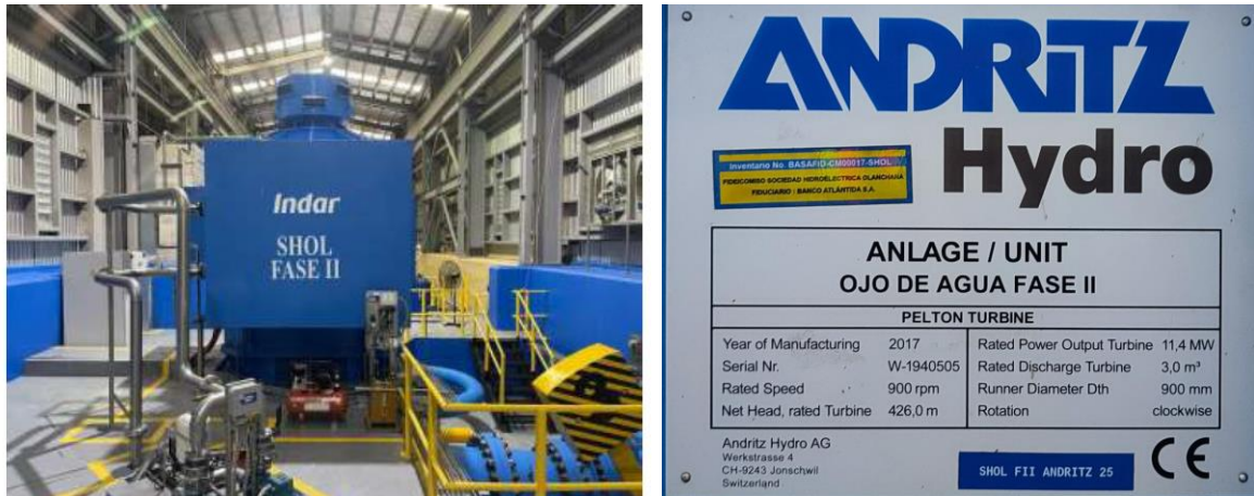
Figura 54 42 Unidad generadora ANDRITZ Hydro 2017 (nueva tecnología)
