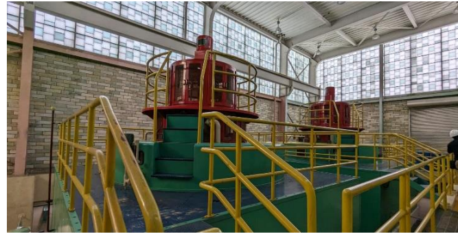
Figura 24 Unidades de generación Cañaveral (fuente propia)
