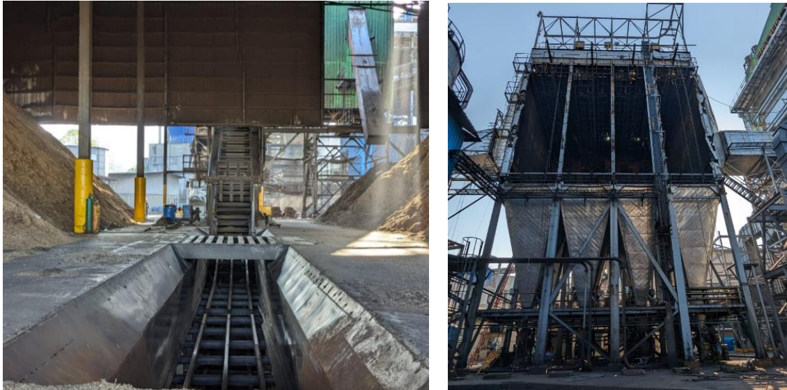
Figura 14 Unidades en mantenimiento, Izquierda: Banda de movilización de material en mantenimiento. Derecha: Limpieza del depósito de ceniza) (fuente propia)
