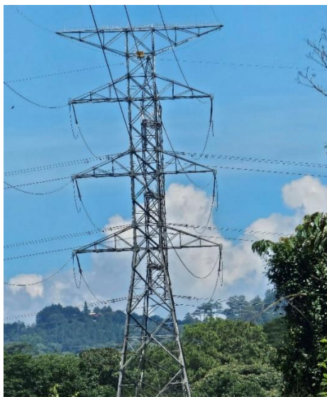
Figura 36 L-622, y L-609 provenientes de la subestación San Buenaventura en la torre 41 propiedad de la EPR (fuente propia).
