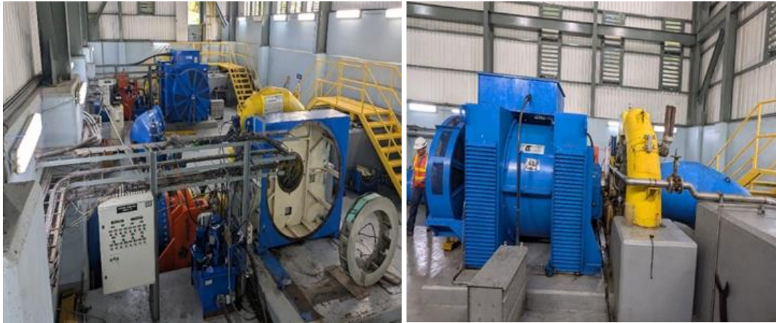
Figura 11 Unidades de generación de la central Cuyamel (fuente propia)
