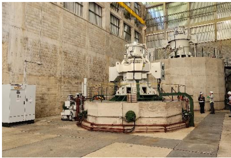
Figura 14: unidad 1 de generación
