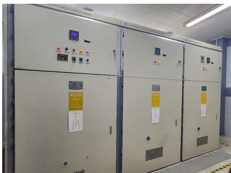
Figura 31: Subestación de la central
