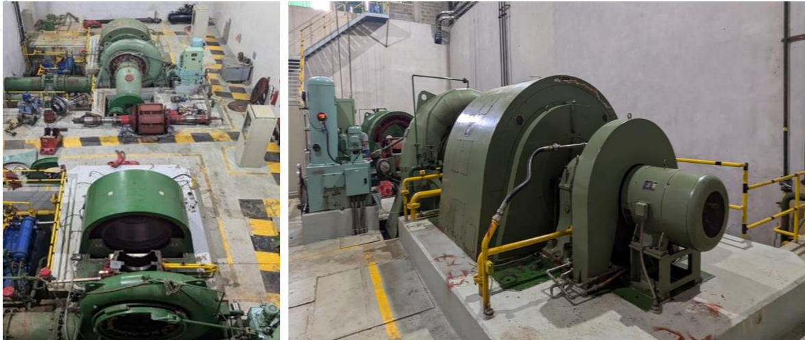
Figura 7 Unidades de generación de la central Chachaguala III (fuente propia)
