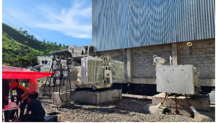
Figura 18: Transformadores de las unidades
