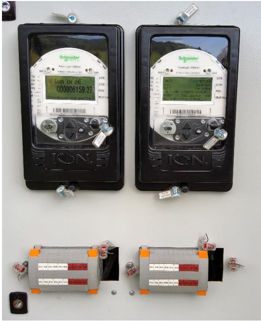
Figura 23: medidor principal y de respaldo
