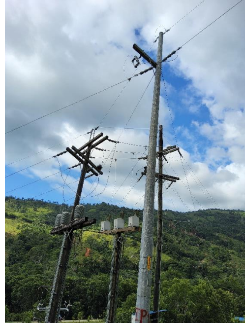
Figura 24: punto de medición y conexión
