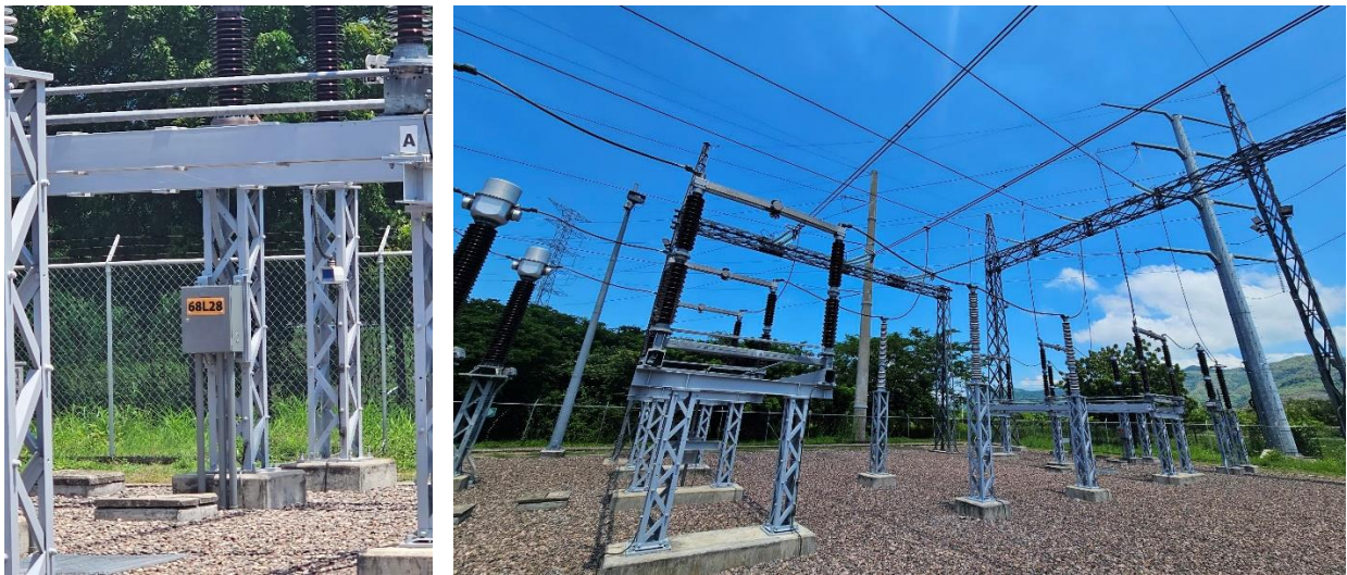
Figura 35 Subestación Agua Caliente, L-682, B-625 (fuente propia).
