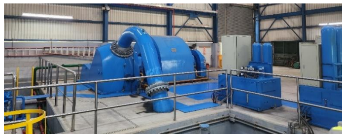
Figura 29: unidad de generación Pelton.
