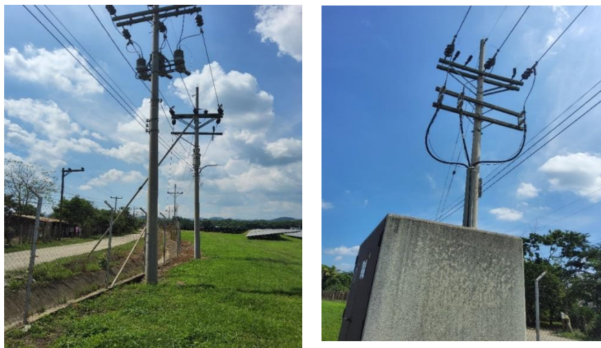
Figura 20 Salida de la central generadora hacia la subestación
