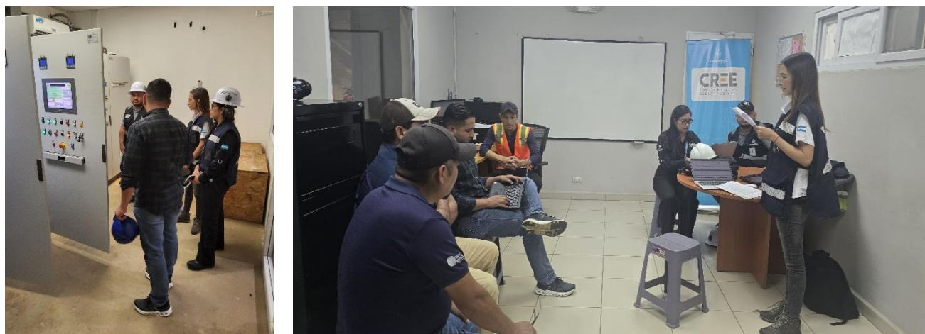
Figura 8 Instalaciones de la central hidroeléctrica Cuyagual
