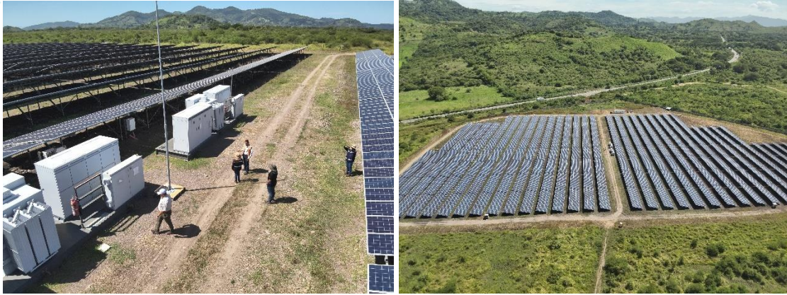
Figura 1 Unidades de generación de la central Fray Lázaro (fuente propia)
