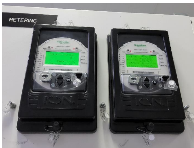
Figura 24 Medidor principal y de respaldo
