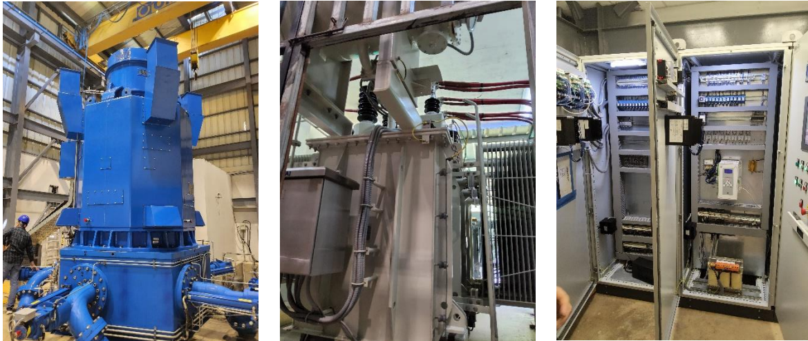
Figura 9 Unidad de generación, transformador y equipo de control de la operación
