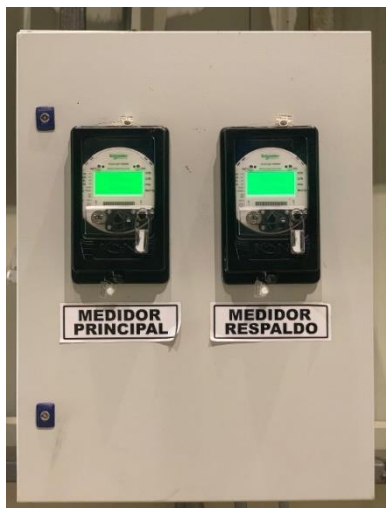
Figura 14 Medidor principal y de respaldo
