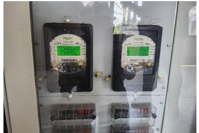
Figura 19 Medidor principal y de respaldo
