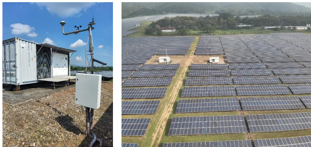
Figura 17 Equipos asociados a la operación (paneles, inversores y transformadores)
